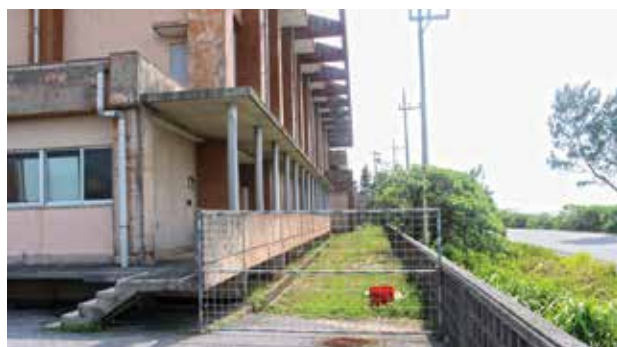
立入禁止箇所
